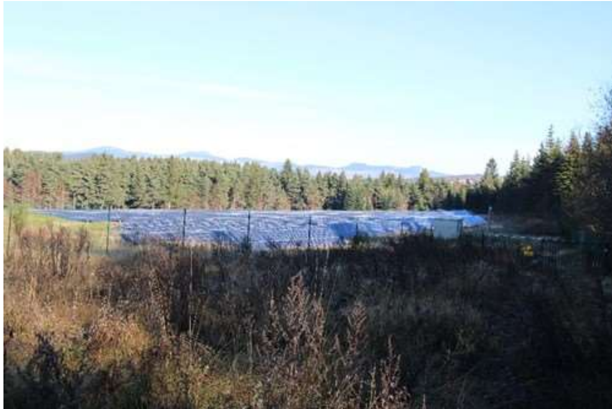
Figure 191 : Le parc photovoltaïque existant - T&P
